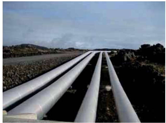
In riesigen Pipelines wird die Erdwärme über weite Strecken transportiert.
