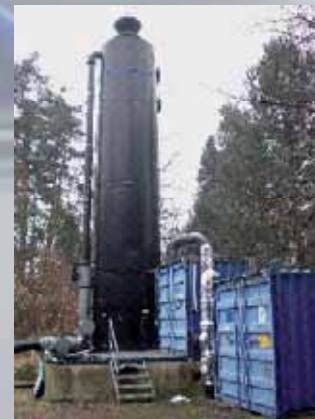
Abreinigungsanlage für CKW's. 170.000 Liter verunreinigtes Grundwasser werden pro Stunde gereinigt, auch wenn es keine Trinkwasserentzug gibt. Mit einer Schadstoffbelastung von 25-30µg/Liter gelangt das Wasser in die Anlage. (Maximalwert in der Natur, durch die Verunreinigung bis zu 18.000µg). Gegenruckpumpen, in der Region, sorgen für einen Ausgleich des Wasserspiegels. Nach der Reinigung werden die Gase in die Atmosphäre abgegeben, der Grenzwert von 10µg wird nicht erreicht (1-2 µg). Quelle: Valentin Gauß.
